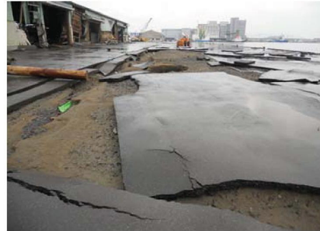
写真-1 東日本大震災における護岸の被災 (石巻市)
